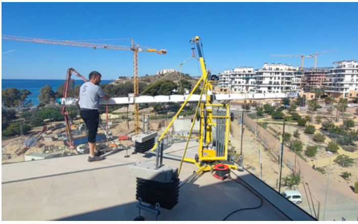
Preparada para 2 escenarios de elevación. Elevación sin techo usando contrapesos.
